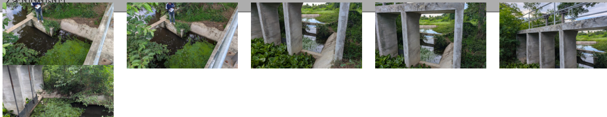
3 ส่วนควบคุม
