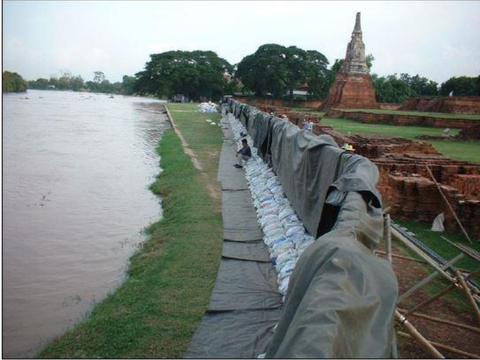
รูปที่ 4-12ข แสดงตัวอย่างการติดตั้งพังกั้นน้ำแบบประกอบ
