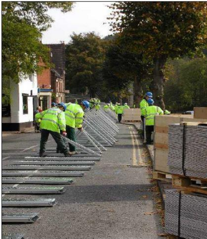
รูปที่ 4-6 ก แสดงการติดตั้งโครงสร้างแบบแผงกันน้ำมีโครง
